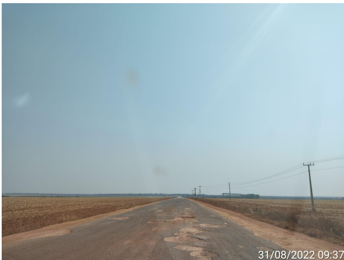
Figura 16, 17 e 18 – Trecho da MT 338 com muitos buracos.
