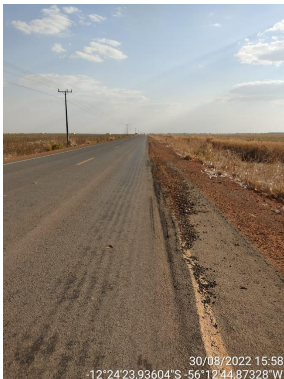
Figuras 14 – defeitos no pavimento
