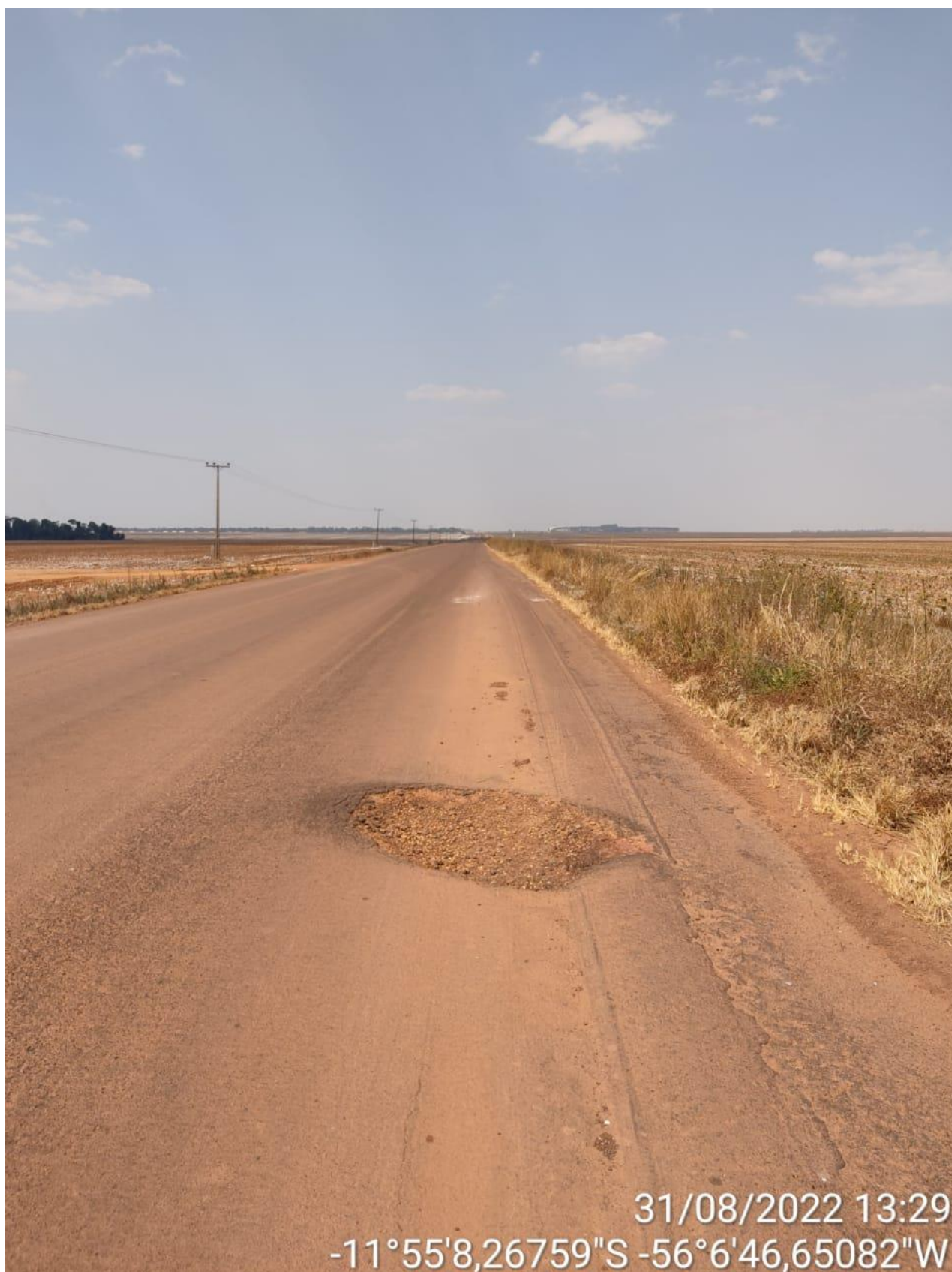
Figura 52 – buraco na via pavimentada.
