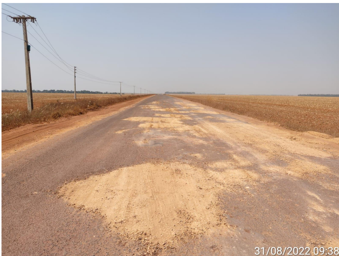
Figura 19 e 20 – Trecho da MT 338 com muitos buracos tampados com terra.
