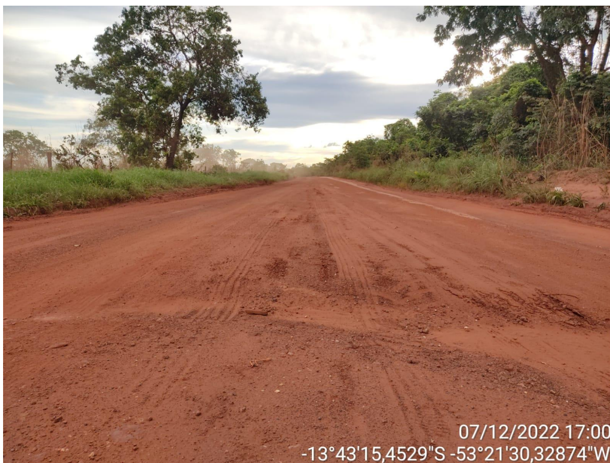
Figuras 134, 135 e 136 – trecho não pavimentado da MT 129.
