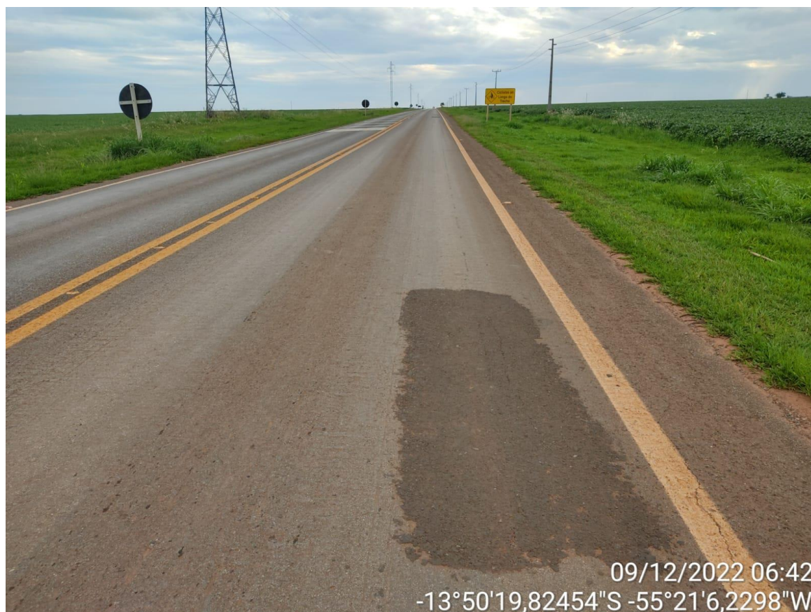
Figura 29 – Trecho com o pavimento remendado da MT 140.
